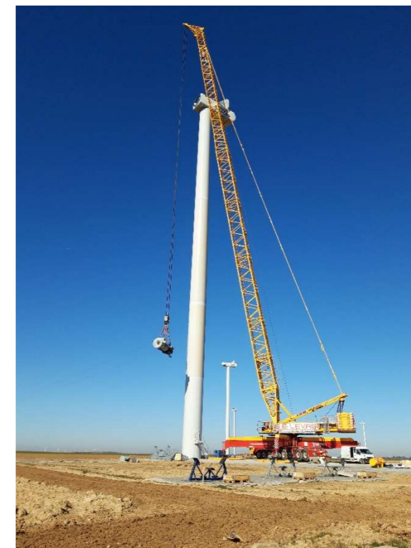
Figure 116 : Montage de la génératrice (Source : VOLKSWIND)
